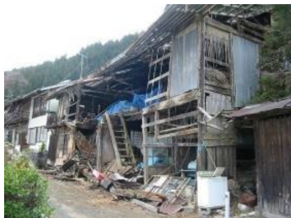
倒壊のおそれのある空き家
