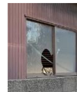
窓が割れた管理不全空家
